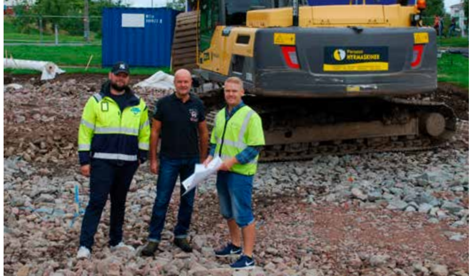
De arbetar med utegymmet. Från vänster Ludvig Larsson från Torslanda Entreprenad, Anders Johansson, bygglidare från Ramböll och Björn Mogren från Viaq som är Park- och Naturförvaltningens projektledare.
